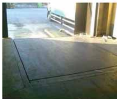
Sin delimitación de rampa de carga
