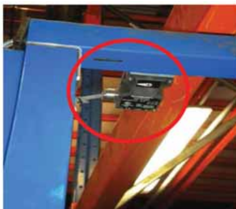
Puerta de acceso a un transelevador
