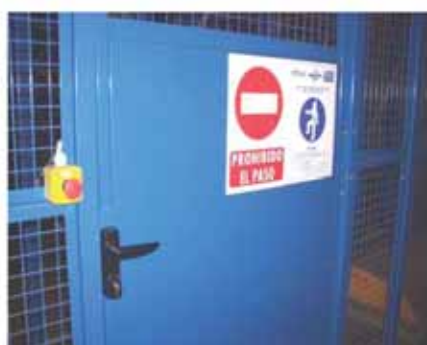
Puerta de acceso a un transelevador
