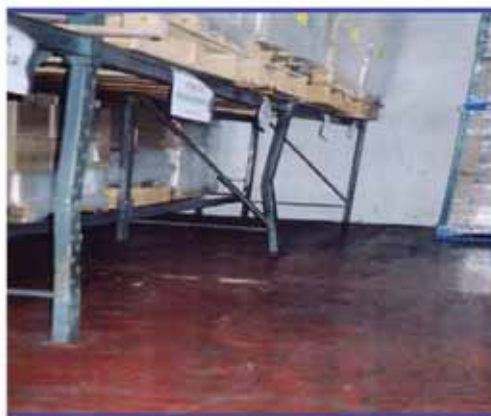
Puntales sin protección
