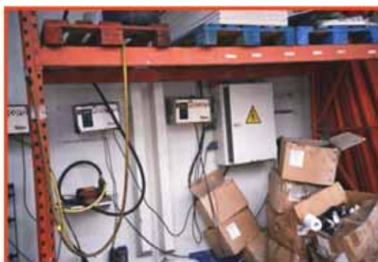
Ubicación inadecuada de los cargadores
